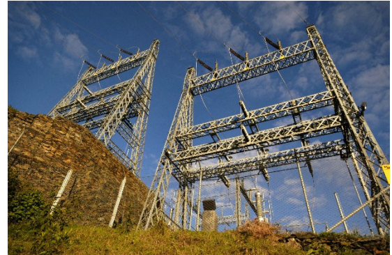
Subestación Pichu Este
